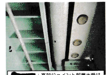
高架ジョイント部漏水受け
