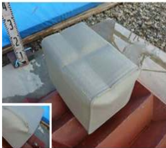
3mm厚 3mm塗装の損傷状況
