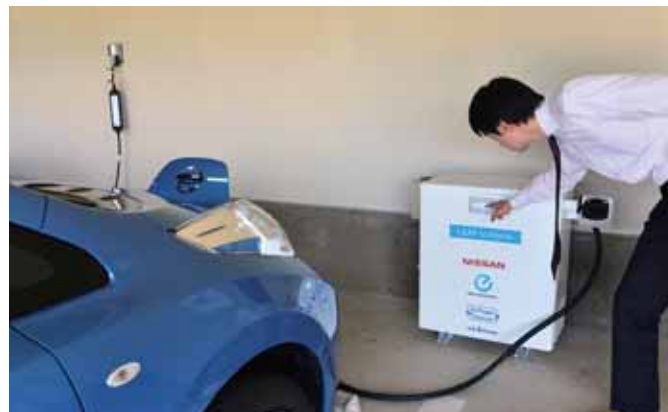
通常のEVへの充電のほか、緊急時にはEVのバッテリーにある電力を活用することもできるタイプの充電器（V2H対応）を、3台導入している。
