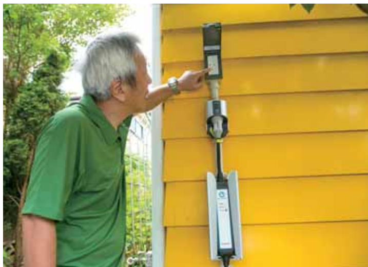
家の壁面に充電設備を設置。充電は、充電用コンセント手元スイッチで操作できるほか、充電時間をタイマー設定することも可能だ。
