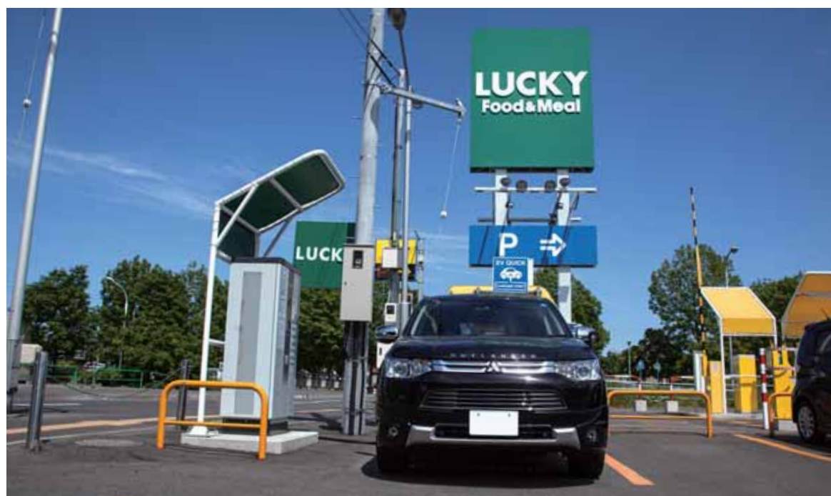
北海道内に35店舗(2015年5月末現在)を構えるスーパーマーケット北雄ラッキーは、2014年、17店舗に1基ずつEV・PHEV用急速充電器を設置。北海道では一般企業が公共インフラ的に急速充電器を設置することはまれで、食品スーパーでは初めての試み。
